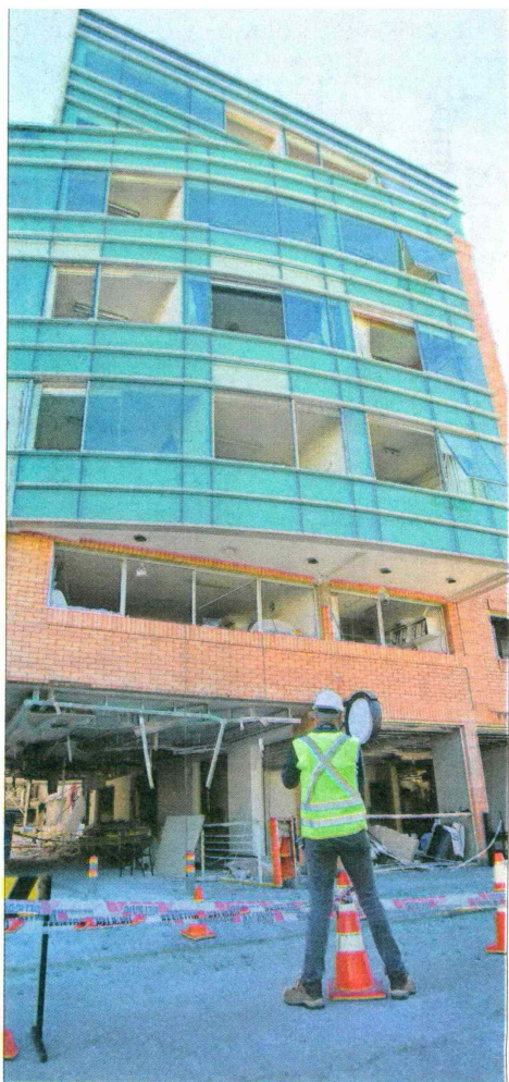
INFORME PENDIENTE. — Así lucía ayer la torre más dañada por la explosión del sábado. Aún no existe una evaluación estructural de esas dependencias.
